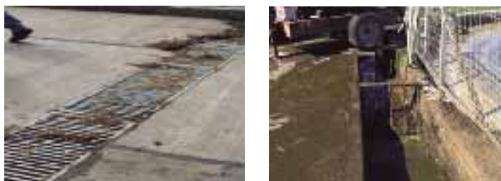
Foto 4.1. Rejillas para evitar el ingreso de residuos de forraje y material extraño al pozo purinero.
