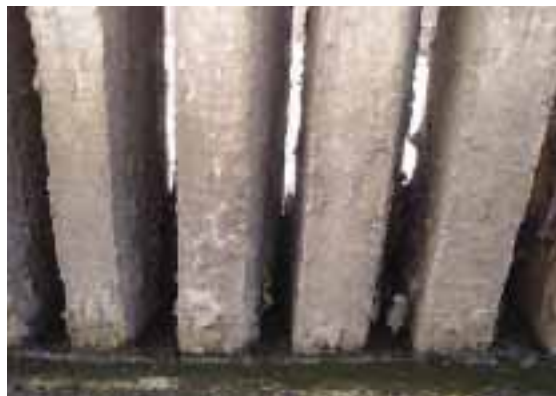
Foto 4.8. Detalle de separación entre columnas.
